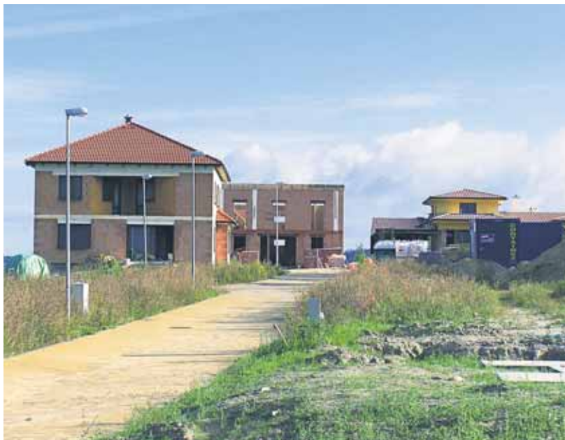
Rozostavané, neobývané a nezabezpečené stavby sú pre zlodějov ľahkou korisťou.
