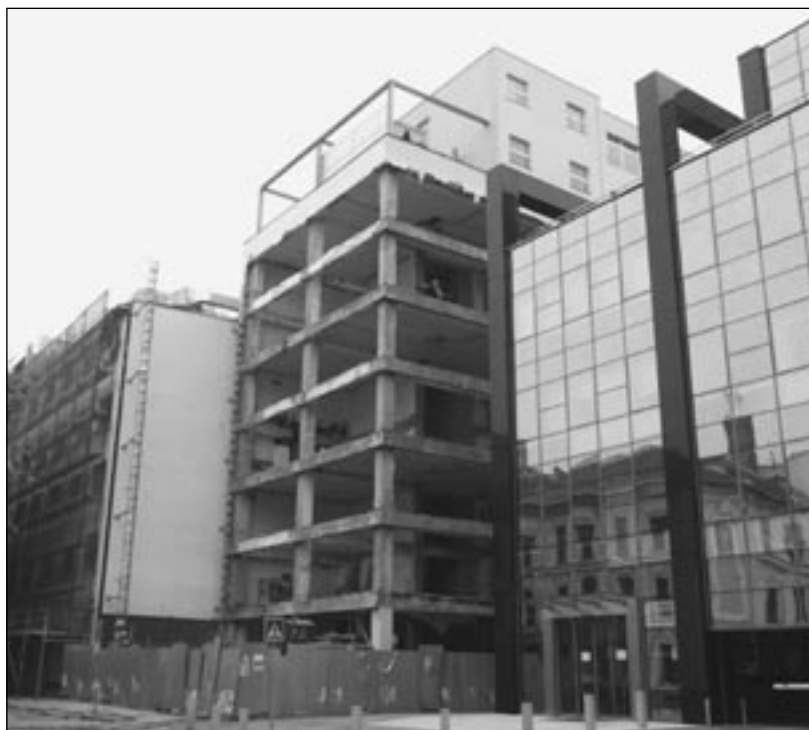
Neporiadok stavebník odstránil až po sankciách
