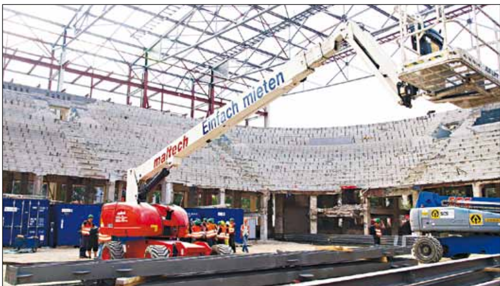
Rekonštrukcia Zimného štadióna Ondreja Nepelu, ktorá sa oficiálne začala 23. apríla 2009, pokračuje v súlade so schváleným harmonogramom realizácie stavby.
