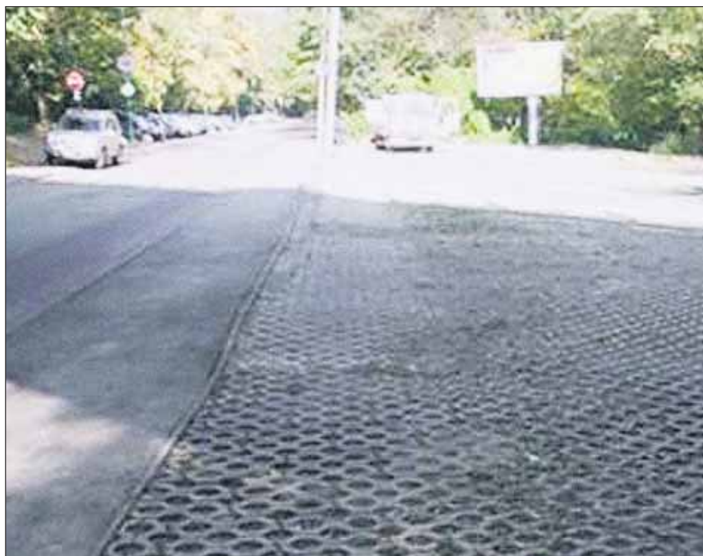
Mestský parkovací systém s Mestskými lesmi opravili parkovisko pod Červeným mostom na Ceste mládeže na Železnej studienke. Okrem toho, že vymenili chodníkové obrubníky, znížili ich výšku. Doplnili chýbajúce zatravnovacie tvárnice, vyrovnali nerovnosti a priehlbiny. Kapacita parkoviska sa nezmenila, náklady na opravu sa „vyšplhali“ na 7 000 eur.
