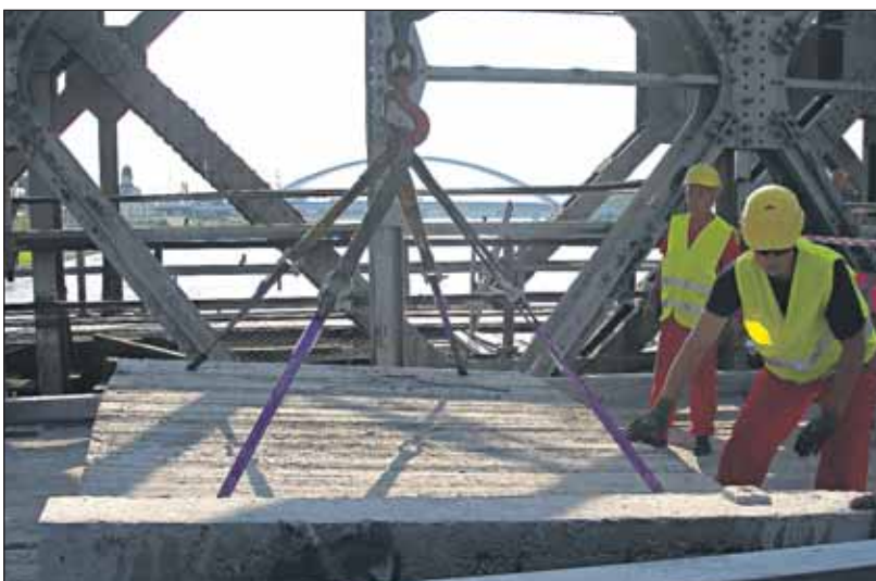
Tri tony váži jeden takýto panel, do odstránenia ktorých sa pred vyše týždňom na cestnej časti Starého mosta pustila spoločnosť METRO Bratislava.
