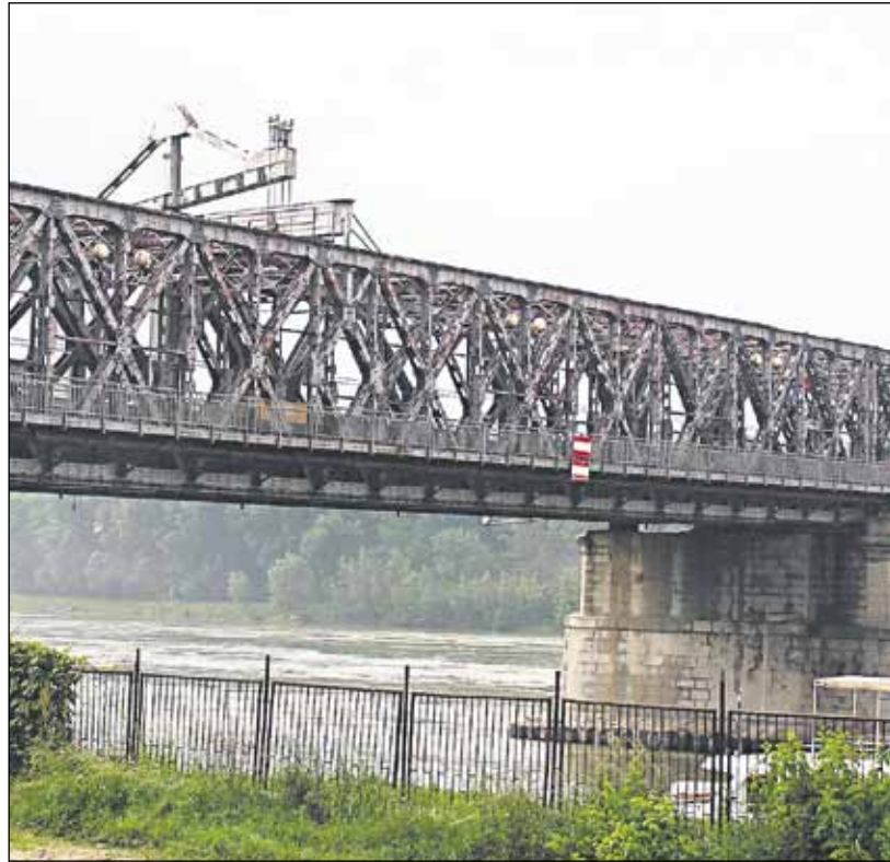
Vzhľadom na šiesty stupeň poškodenia zo siedmich a deformáciu mostnej konštrukcie začnú Starý most postupne rozoberať.
