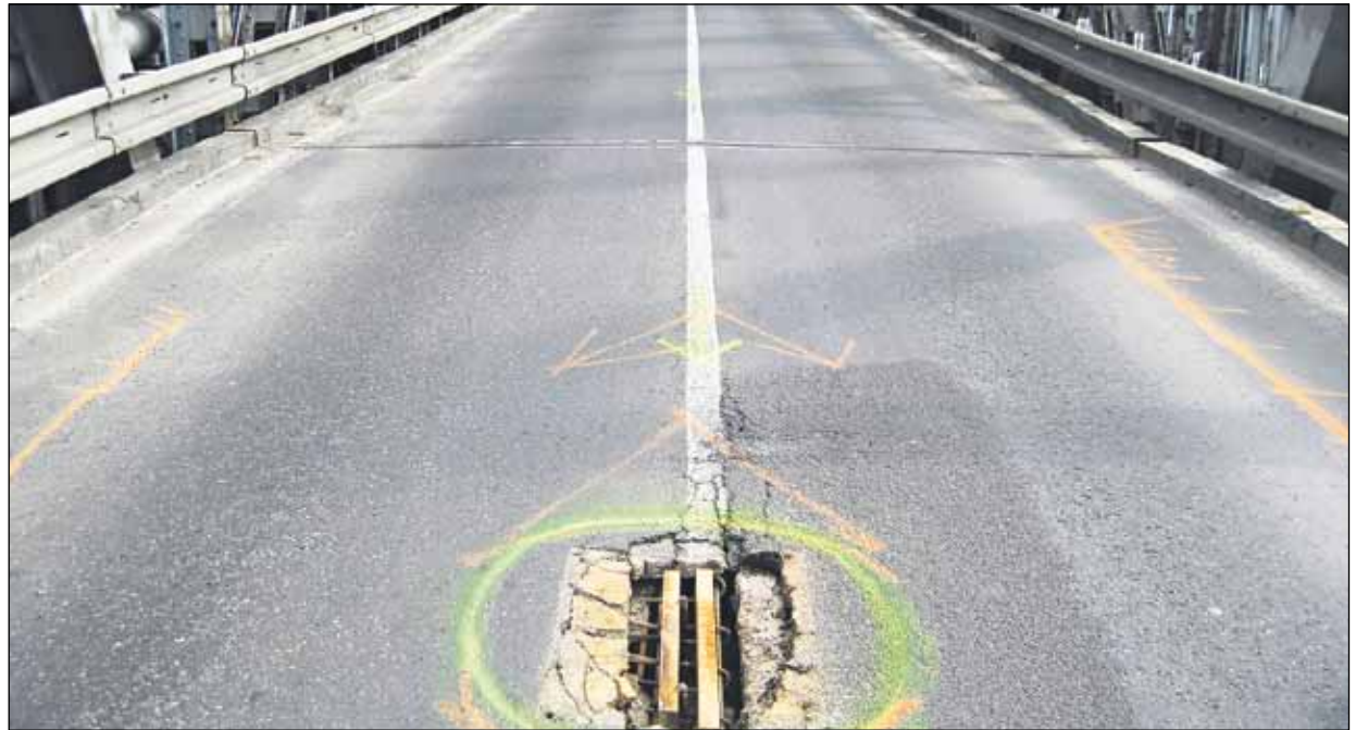
Vypadávajúce kusy betónu iba dokumentujú kritický stav mostu.
