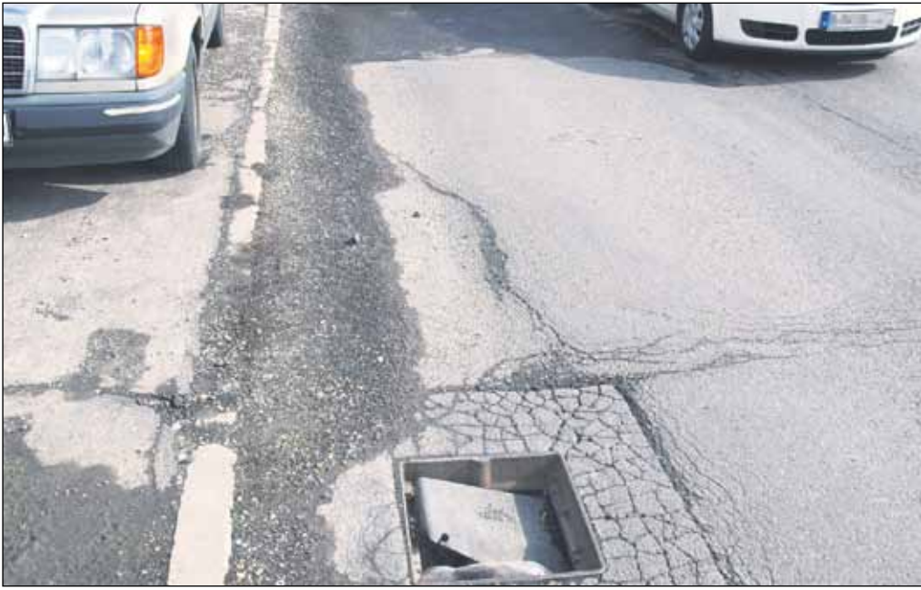
Nielen na Kopčianskej ulici sú ukradnuté kanalizačné poklopy hrozbu pre obyvateľov i pre vodičov.
